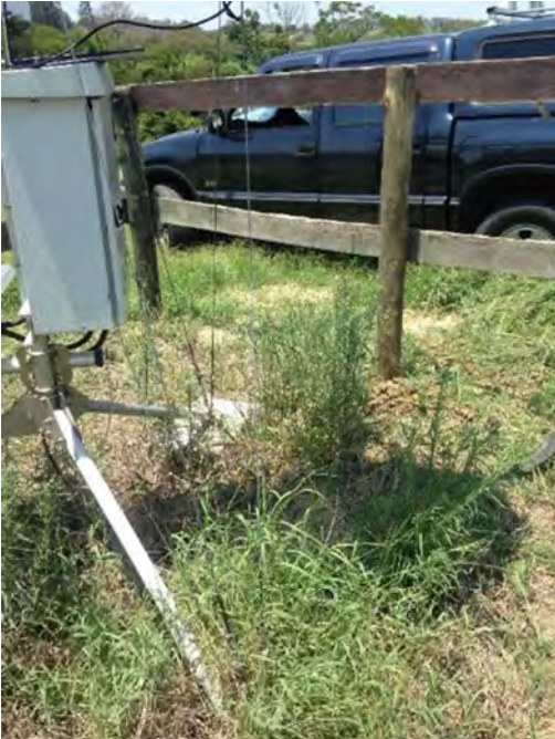
Vegetação alta dentro do cercado da estação EFM
